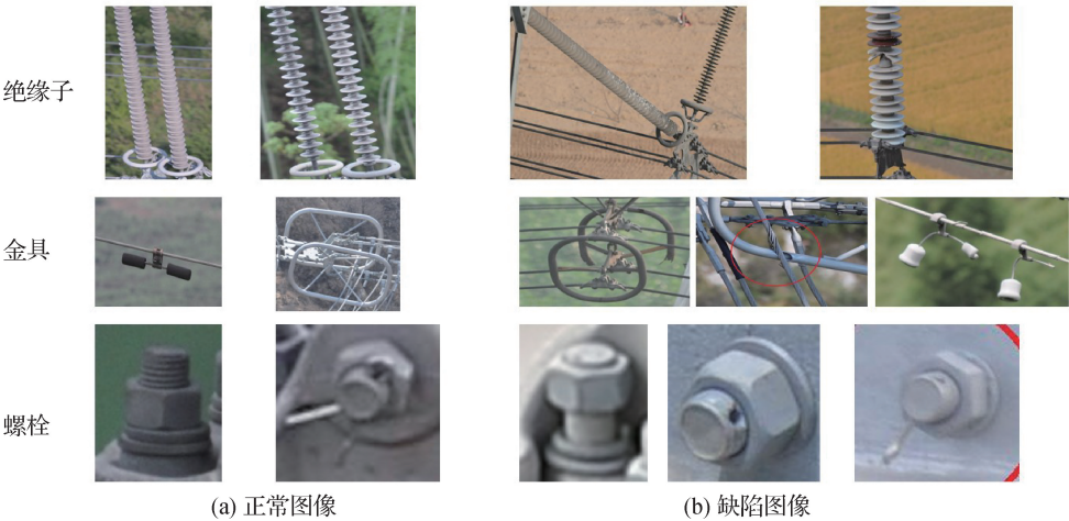
图 2 输电线路各部件正常样例及缺陷样例
